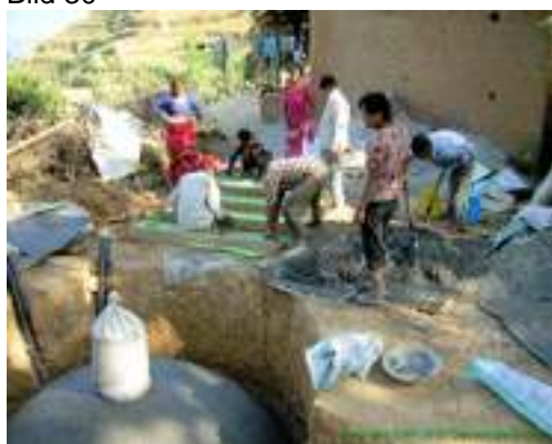
Vor Ort werden Schalungen angelegt in den Stahlbetonplatten gegossen werden. Diese decken aus Sicherheitsgründen zukünftig den Überlauf (Outlet) ab.
